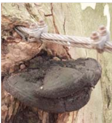
Bolzen in deutlich sichtbarer Faulstelle
