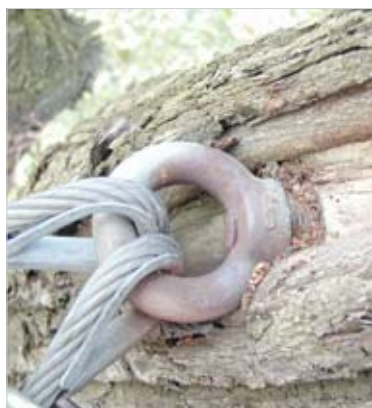
Bolzen in gut erkennbarer Faulstelle
