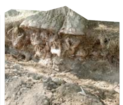
Fehlt der Bordstein, wird der Baum instabil.
